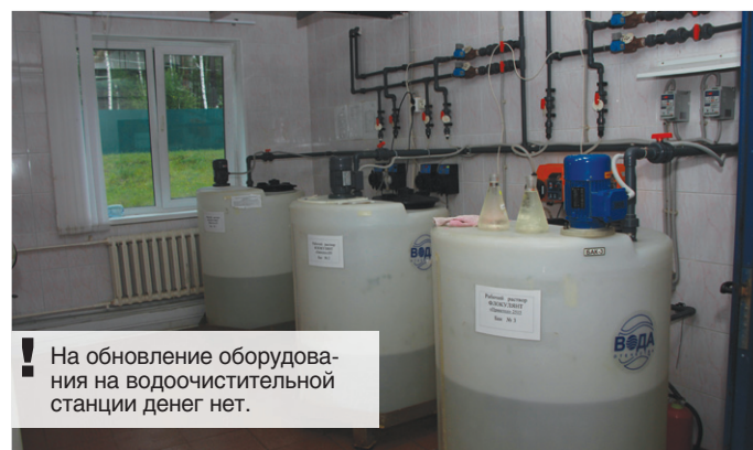
Ожидаемая авария на водопроводе.
